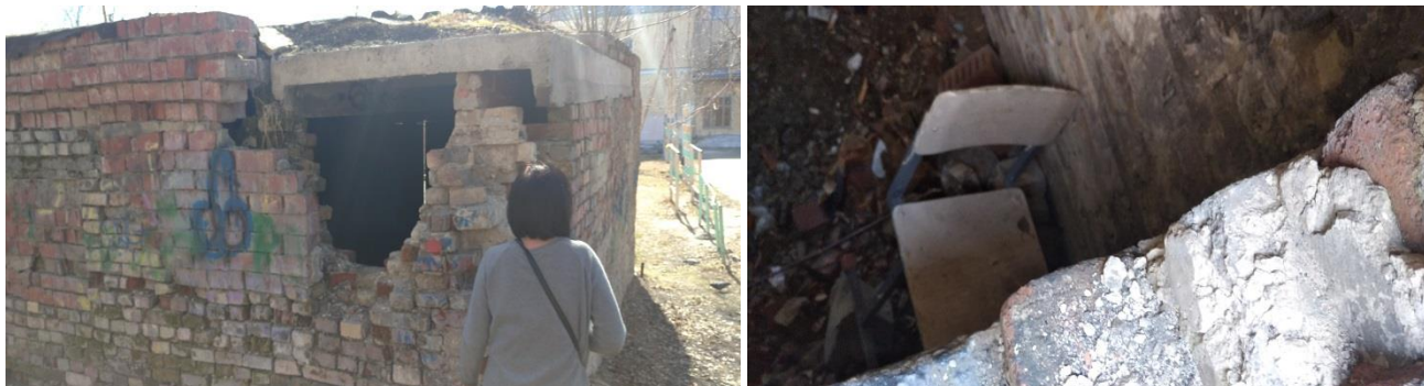
Фото 11-12. Полуразрушенное здание на заднем дворе Гимназии № 25, г. Ревда
